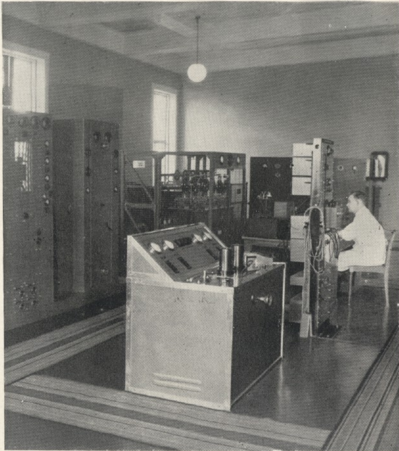
Panel: S. W. Transmitter (7 Kw.)
